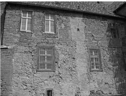
Teil der freigelegten Südfassade mit Schadensbild und historischen Bauspuren
